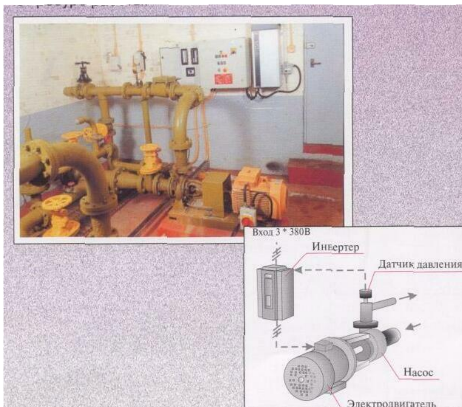
Насосная установка системы водоснабжения
